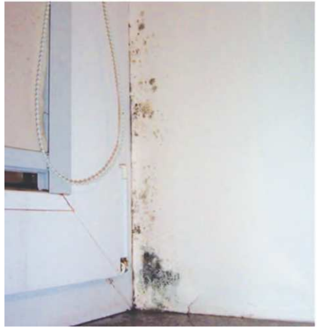
Пліснява на привіконних зонах, що є результатом недостатньо ефективної вентиляції та неправильно сформованого вузла примикання віконної конструкції до стінового отвору
